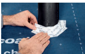
屋顶透气膜穿孔处
